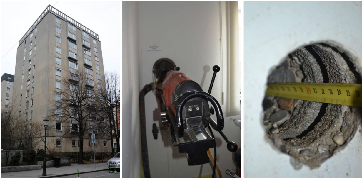
Slike 2.2: Tip B: ena od stolpnic (levo), sondno vrtanje v nosilno steno (sredina) in pregled sestave stene (desno).
