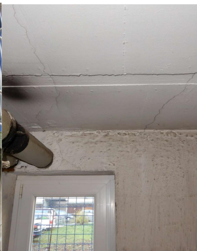
Slika 11: Razpoke na stropnem delu kleti, Streligka ulica 1 (Fotoarhiv: 37503d-10)
