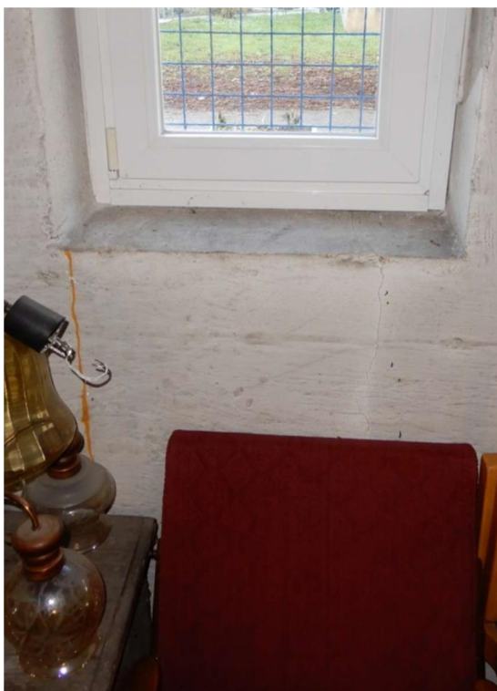
Slika 12: Razpoke pod oknom iz notranjosti, Streliška ulica 1 (Fotoarhiv: 37503d-11)
