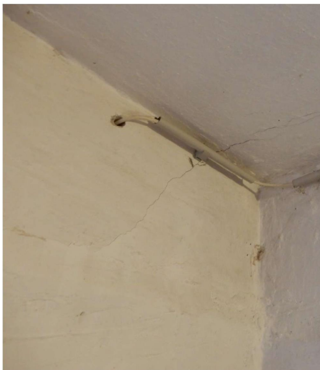
Slika 18: Razpoka na stropu v kleti, Streligka ulica 3 (Fotoarhiv: 37504d-10)
