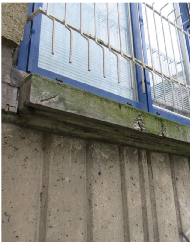
Slika 10: Razgaljena armatura pod oknom, Streligka ulica 1 (Fotoarhiv: 37358d-27)
