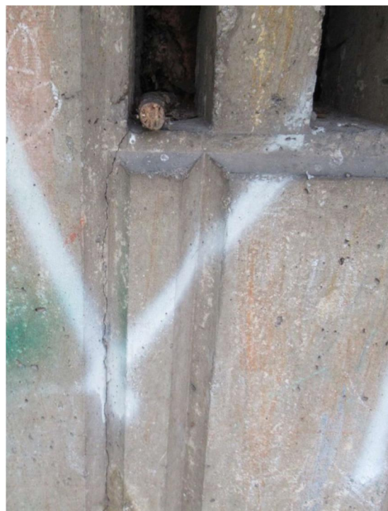
Slika 9: Razpoke pod zračnikom, Streligka ulica 1 (Fotoarhiv: 37358d-28)
