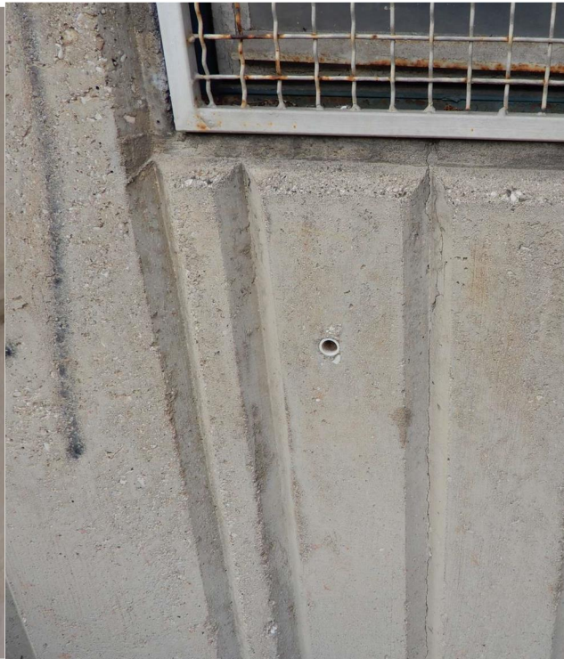
Slika 19: Razpoka pod oknom v kleti, Streligka ulica 3 (Fotoarhiv: 37504d-15)
