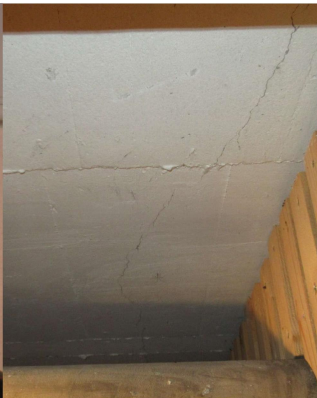
Slika 25: Razpoka na stropu, v kleti, Streligka ulica 5 (Fotoarhiv: 37327d-16)
