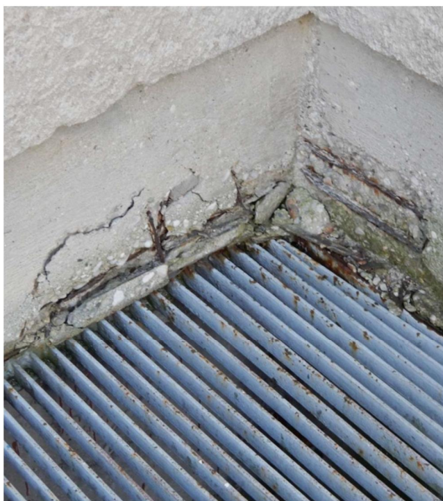
Slika 20: Preperevanje armature na zunanji strani stolpnice, Streligka ulica 3 (Fotoarhiv: 37504d-07)
