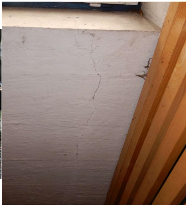
Slika 17: Razpoka pod oknom v kleti, Streligka ulica 3 (Fotoarhiv: 37504d-07)
