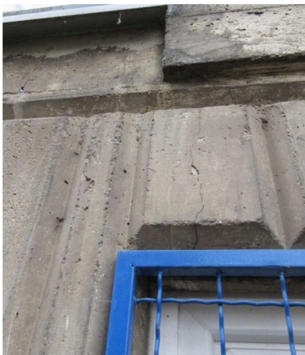
Slika 8: Razpoke nad oknom, Streligka ulica 1 (Fotoarhiv: 37358d-25)
