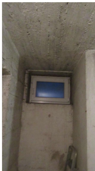
Slika 17: Stena, strop v kleti A1-2, 11.12.2018 (fotoarhiv 37494d-123)
